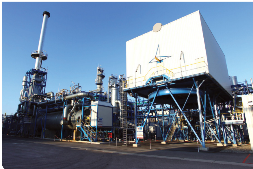
Unité EUROPE2 du site ADISSEO des Roches à Saint Clair du Rhône.
