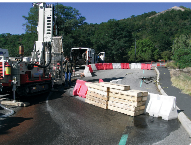
Boulevard Franchet-d'Esperey : affaissement et forages de reconnaissance
