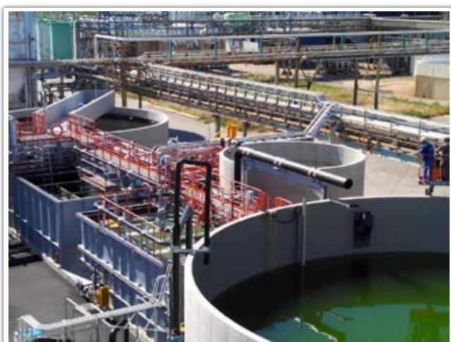
Démarrage de la station d'épuration de l'usine ARKEMA de Pierre-Bénite
