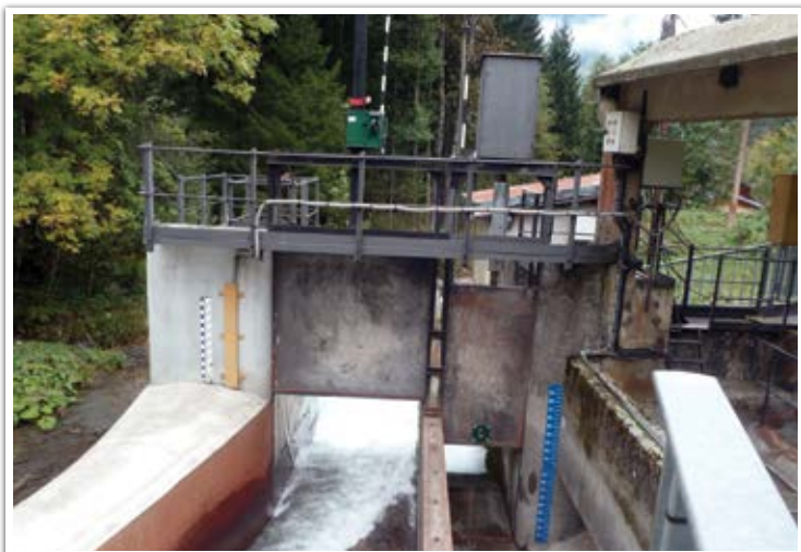
Prise d'eau d'Argentine, concession du Doron de Beaufort (73). © EDF
