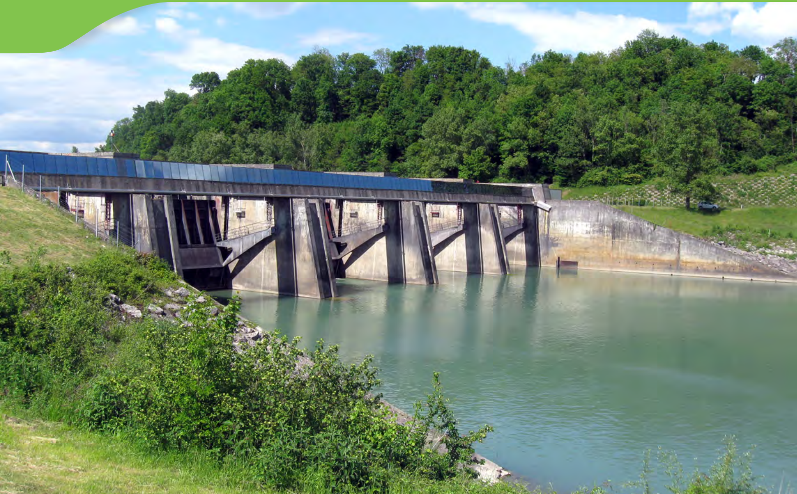
Abaissements constatés au barrage de Chautagne (vue depuis Anglefort) (01)
