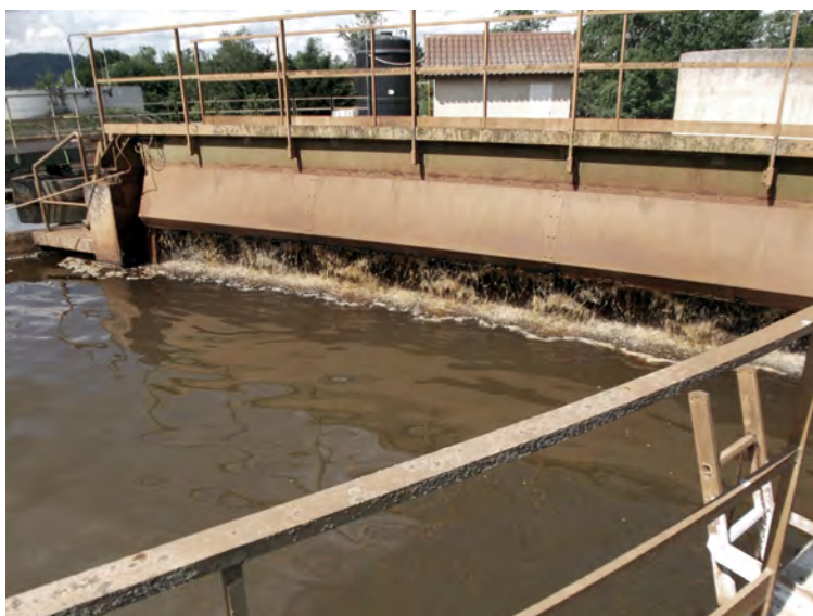
Pont brosse sur bassin d'aération laiterie CFVA - crédit photo "Laiterie CFVA"
