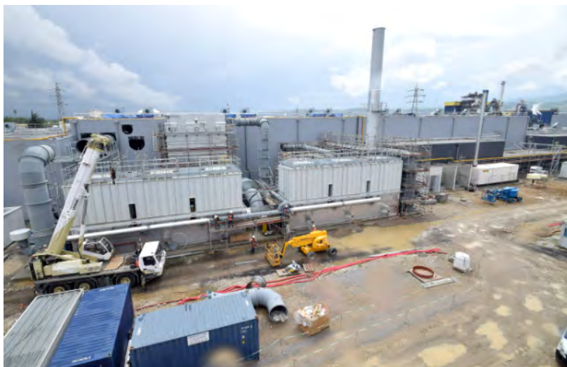
Oxydateurs thermiques - crédit photo "Hexcel Fibers"
