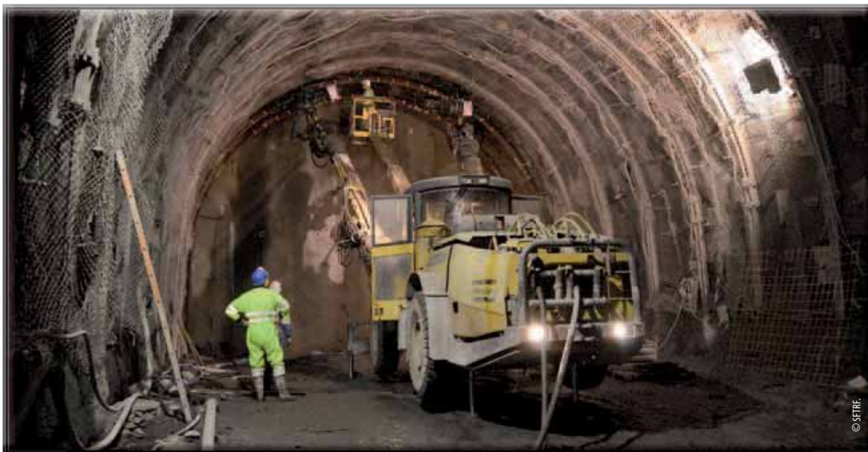
Au coeur de la galerie de sécurité tunnel Fréjus.
