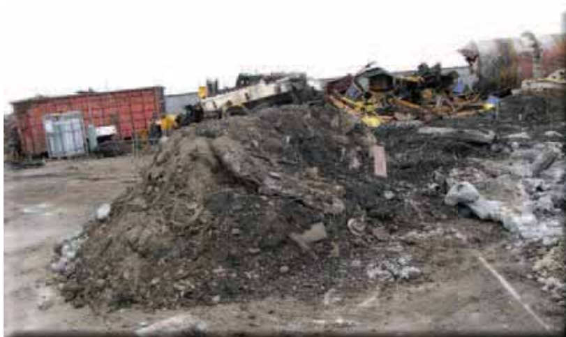
Exploitation non autorisée d'un site en zone agricole à Genas (Rhône).
