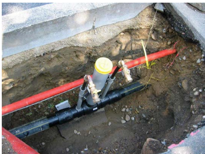
Vue d'un branchement pour la distribution de gaz
