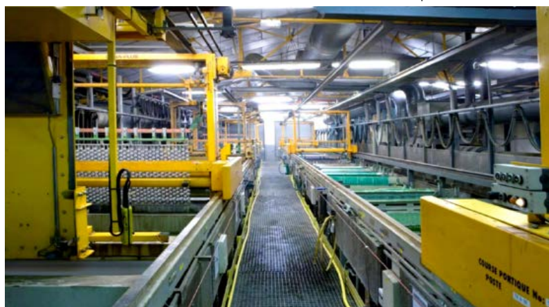
Chaîne de traitement de surface - crédit photo "AURIPLAST"
